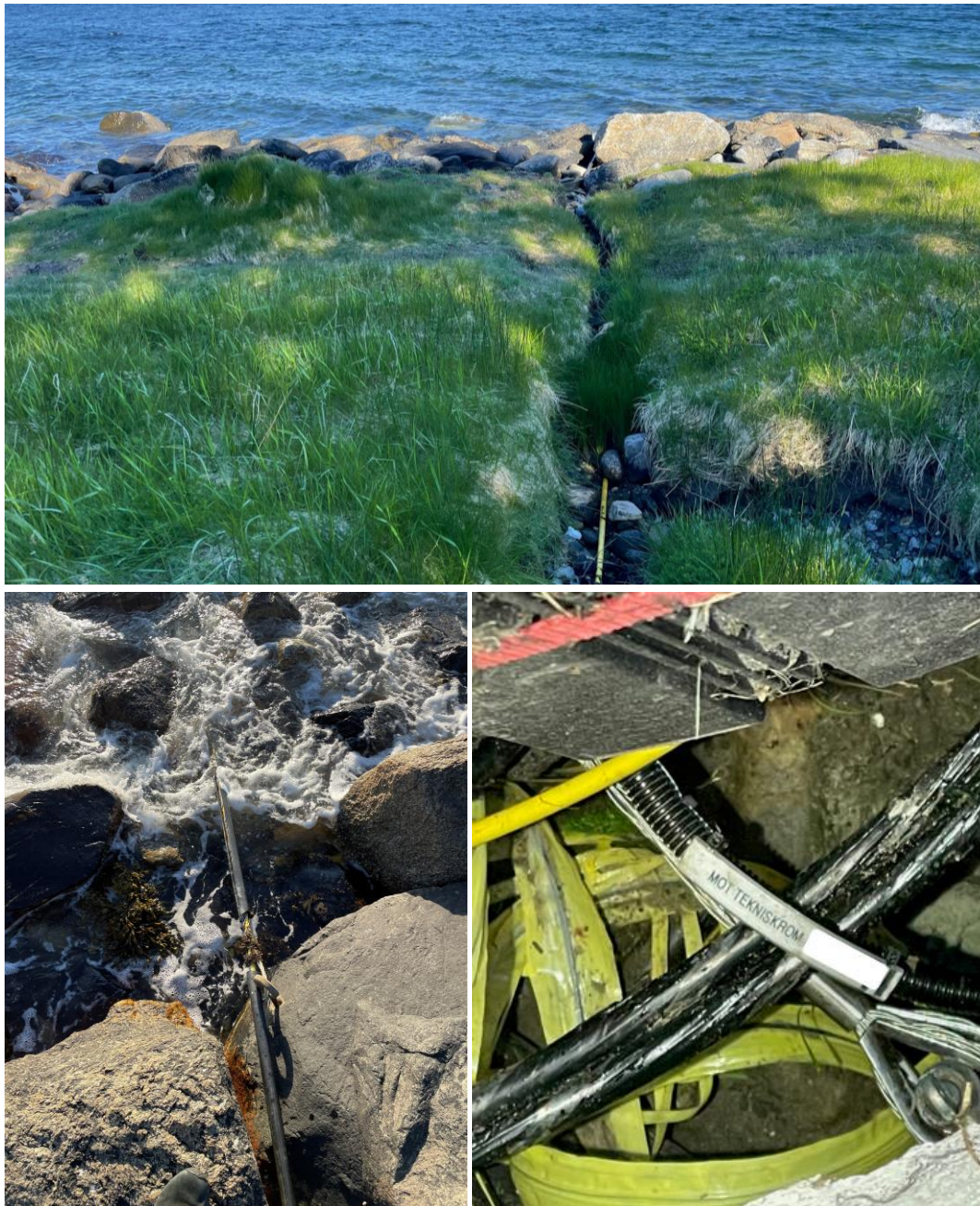
Figur 10: Bilder av utsatte landtak tatt under befarig
