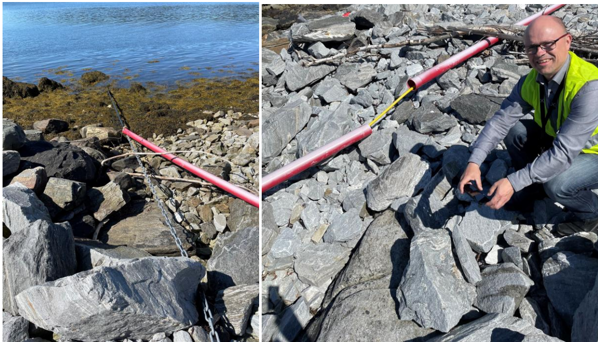
Figur 9: Sjøfibernablere ved landtak uten særlig grad av sikring.
