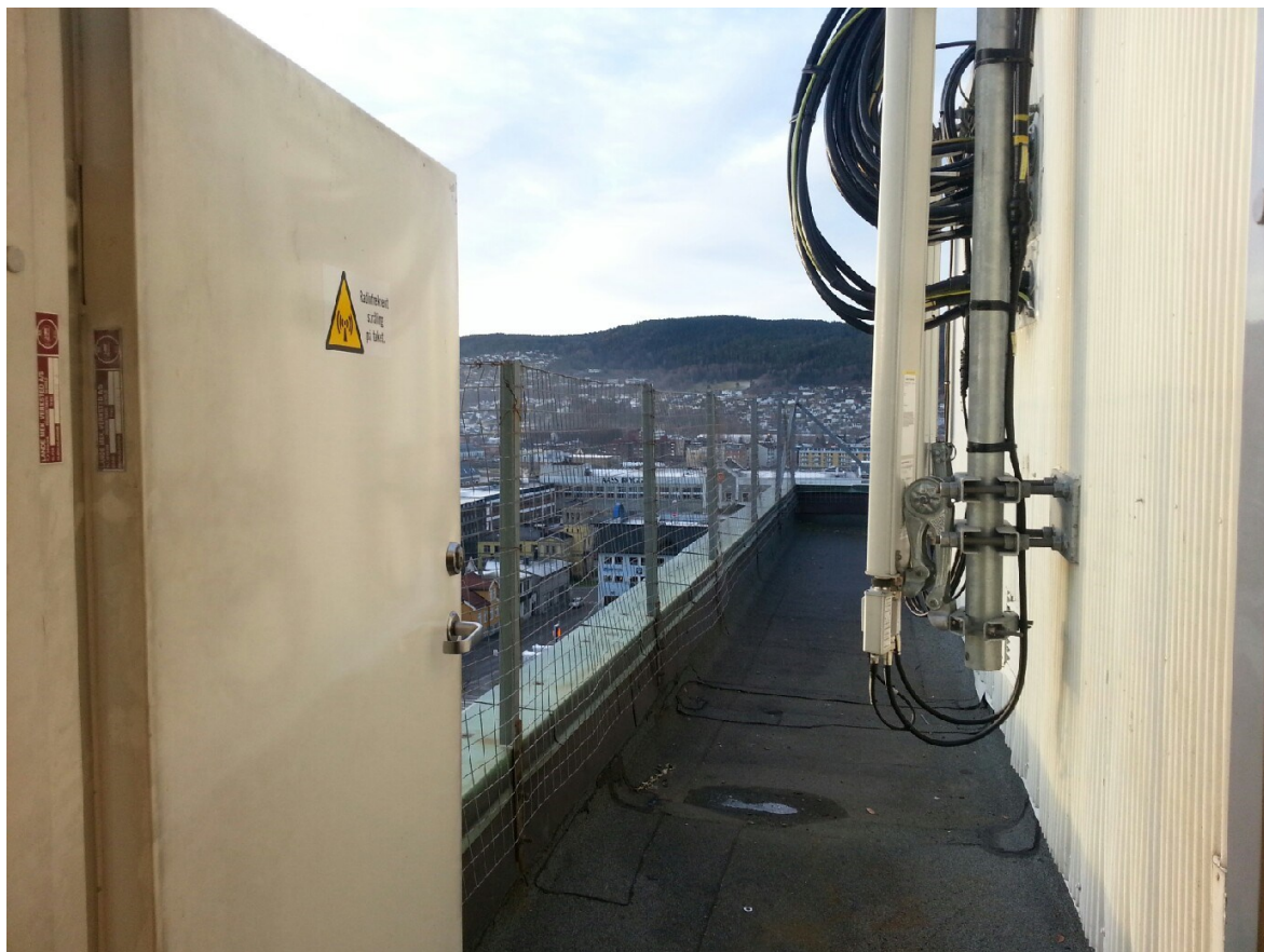
Figur 5: Antenne nr. 5, 6 og 7. Resten på motsatt side av bygget.
