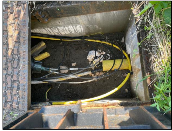
Figur 17: Terminering av sjøkabelen i kum
